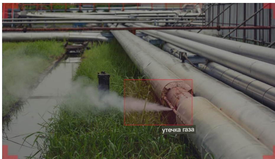
Рис. 1. Утечка газа из трубопровода
