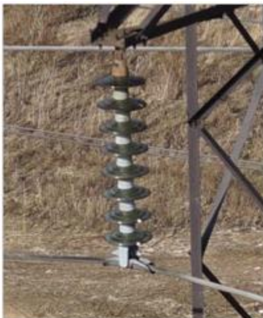
Рис. 9. Изолятор опоры ЛЭП на снимке, полученном с помощью БАС
