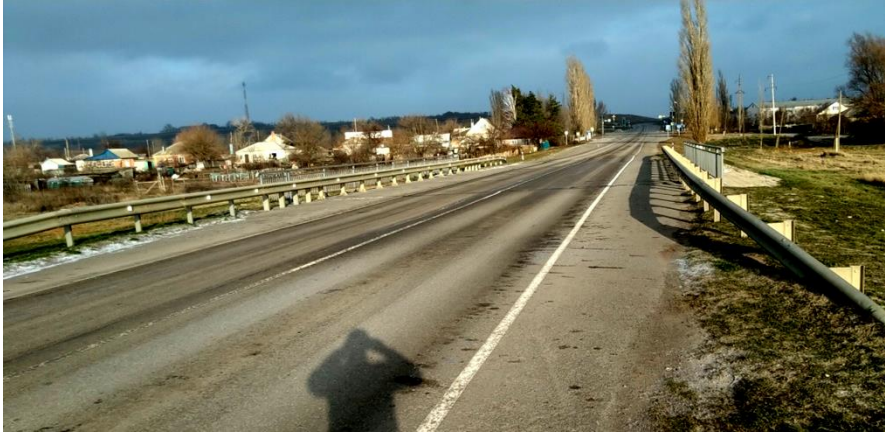
Рис. 1. Гололед на искусственном сооружении (фото Скрылев Г.В. 3.12.2022)
