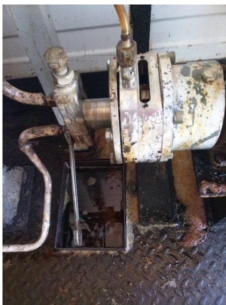
Рис. 1. Разгерметизация насоса-дозатора по узлу соединения уплотнительных сальников с штоком плунжера
