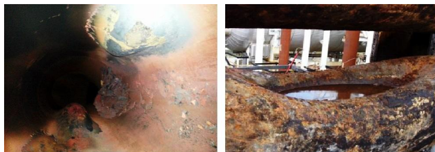
Рис. 3. Деформации жаровых труб
