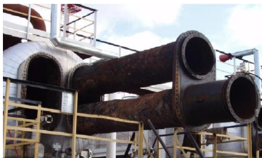
Рис. 2. Жаровые трубы нефтегазодоразделителя
